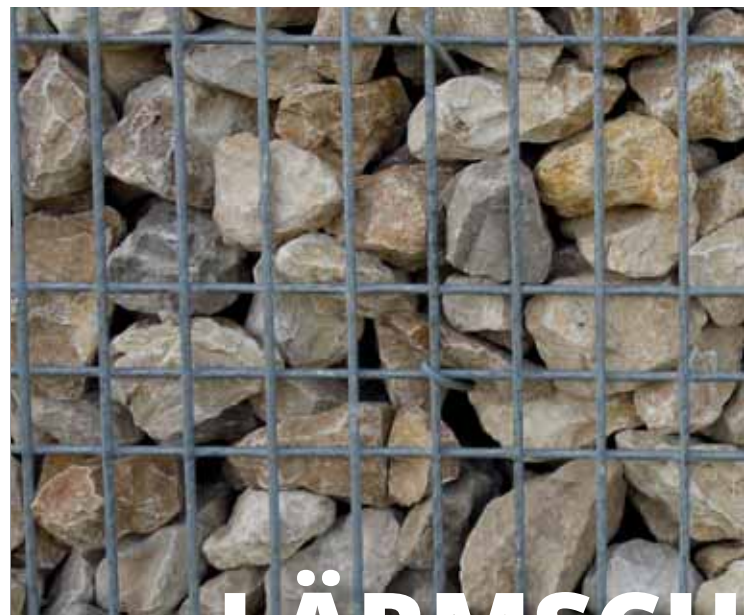
Sileno Plus, Lärmschutzwand, Pfraundorfer Dolomit, geschüttet
